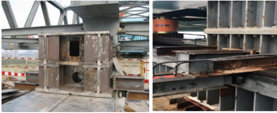
图2.1.4 钢梁支撑滑块及纠偏装置外形实物图 图2.1.5 顶推过程中纠偏施工
